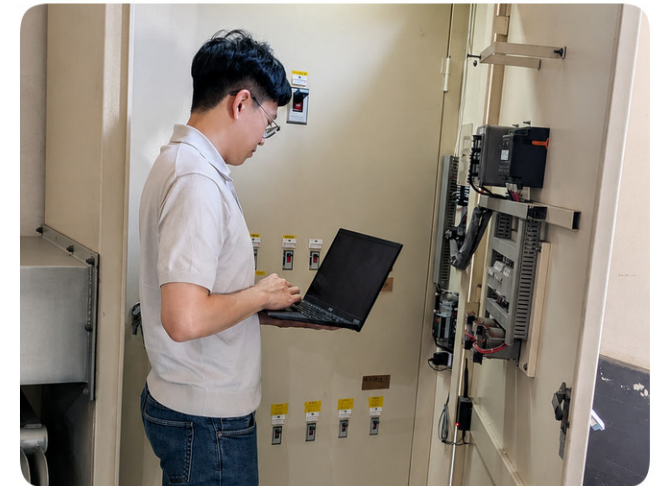
▲ 能源設備巡檢與用電監測
